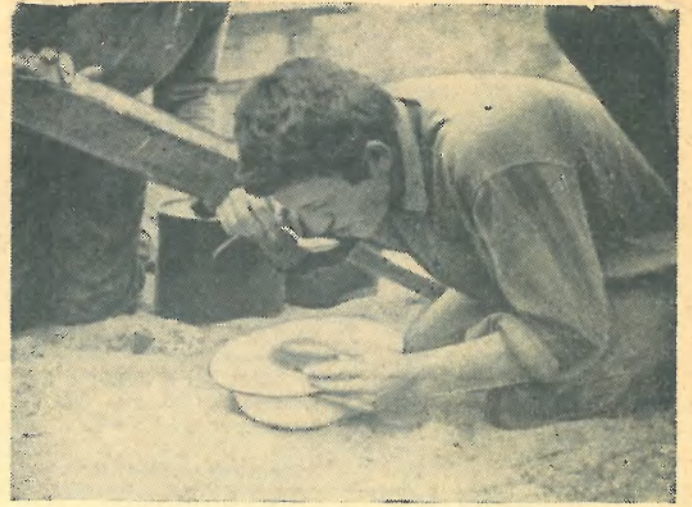
Идет бетон. Обедать приходится на рабочем месте. На снимке: менделеевец Алик Гройсман.
